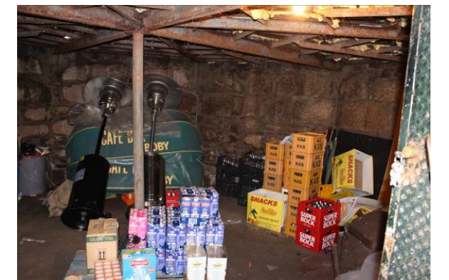
Almacén situado bajo el palco en el que se aprecia el suelo de tierra.
